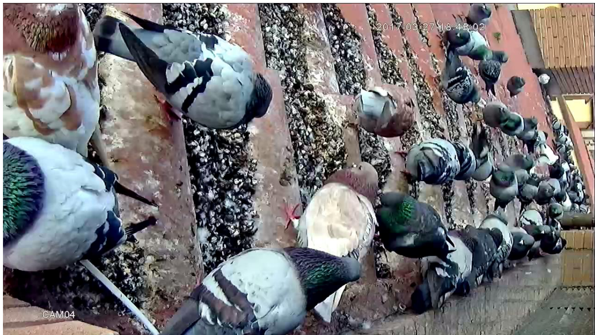
Figura 7. Tejado norte antes de la puesta del sol (18:45) el 27 de marzo de 2017, tres días antes de la instalación de los platos de PET vacíos.
