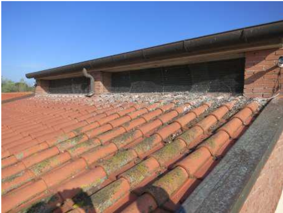
Figura 1. Tejado sur antes de la limpieza y tratamiento.
